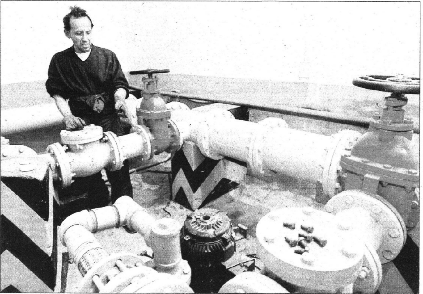
La sobrecarga de energía en una subestación bajo control de la Comisión Federal de Electricidad provocó problemas en el sistema de bombeo de agua potable en la unidad Lindavista Vallejo, lo cual afecta a más de mil familias ■ Foto Carlos Cisneros
