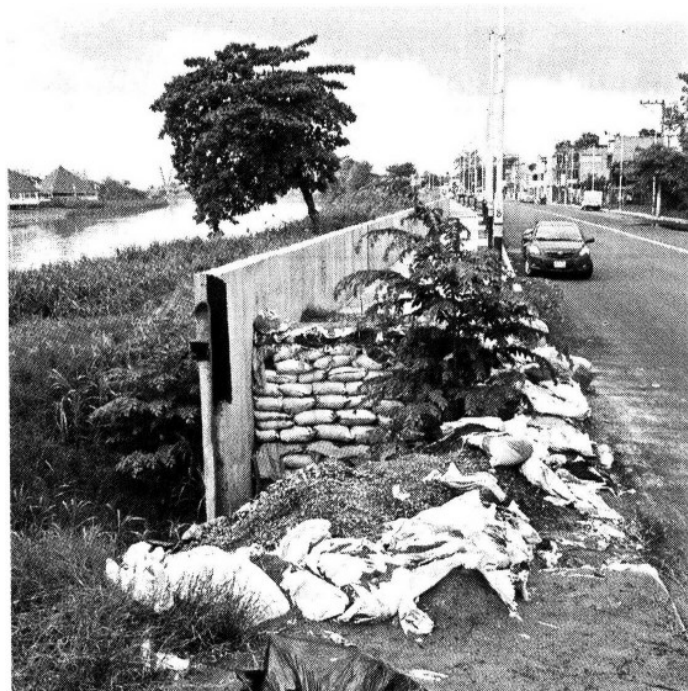
› Varios tramos del Grijalva no tienen todavía bordos de protección.
