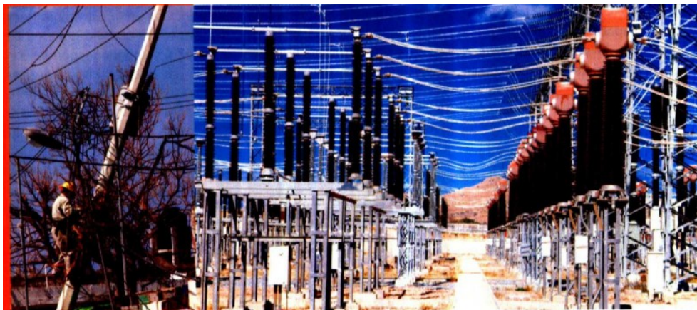
MÁS QUE HACER VERDADERAS MODERNIZACIONES, CFE EMPLEA 'PARCHES' PARA CORREGIR LO URGENTE. EN LA FOTO: SUBESTACIÓN DE LA CENTRAL EL ENCINO, CHIHUAHUA
