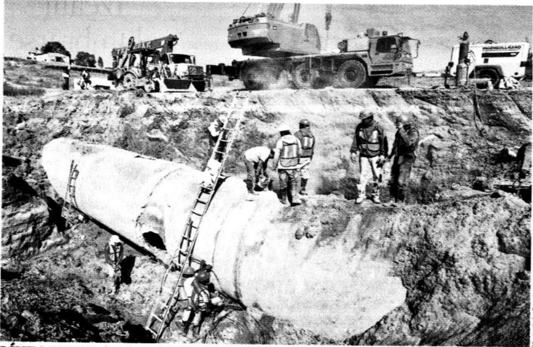
LÍNEA VITAL. La tubería de la línea 1 se dañó por el tiempo y se espera que el nuevo ducto dure 30 años.
