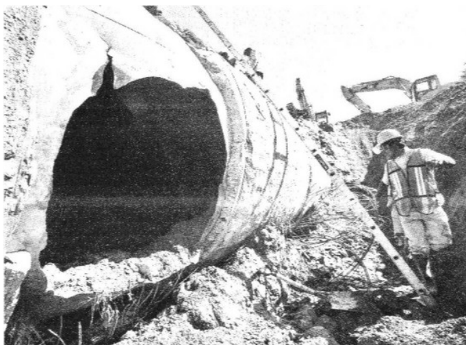
Para reparar el daño en el Cutzamala colaboraron cerca de 200 personas entre personal de seguridad, de Conagua y demás trabajadores.
