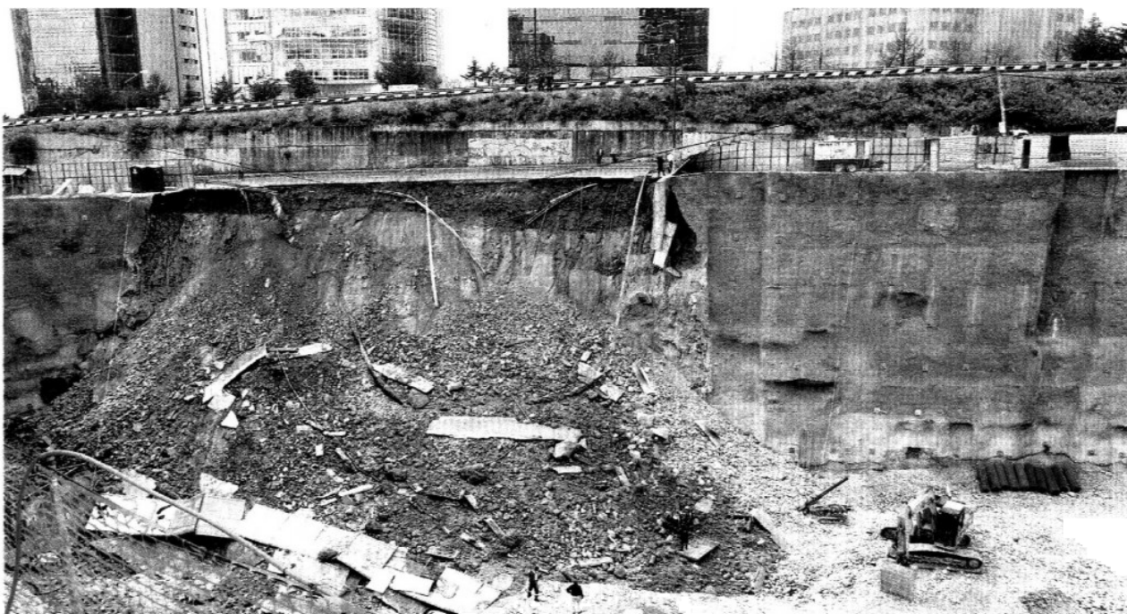
El socavón dañó el carril derecho de la vialidad, la acera, así como postes telefónicos y de energía eléctrica
