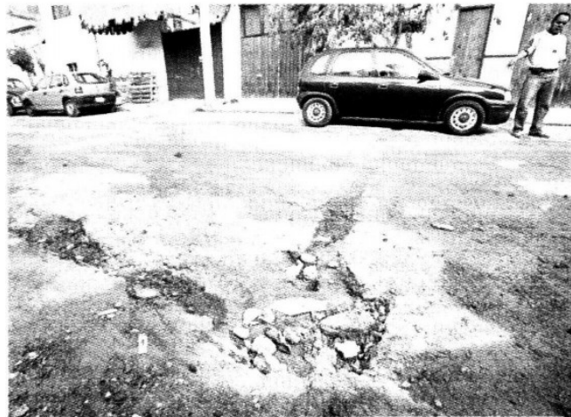
► Los vecinos indican que la calle 5 de Mayo está sobre minas.
