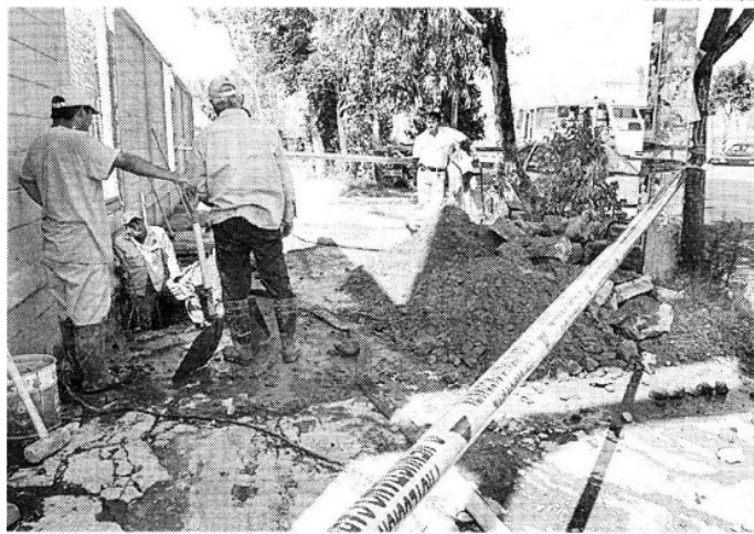
Rupturas de tuberías causan gran pérdida de agua potable
