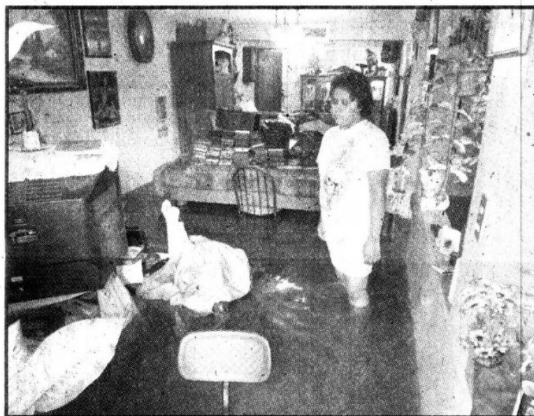
Vecinos de la colonia Plazas de Aragón, en el municipio de Nezahualcóyotl, amanecieron inundados por aguas negras.
