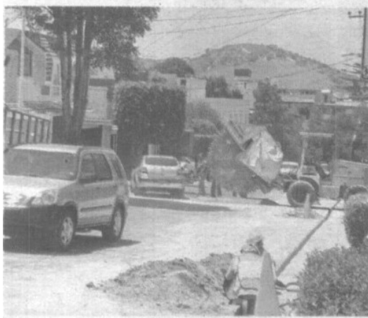
Los trabajadores dijeron a los vecinos que cualquier daño a sus propiedades sería cubierto por su empresa
