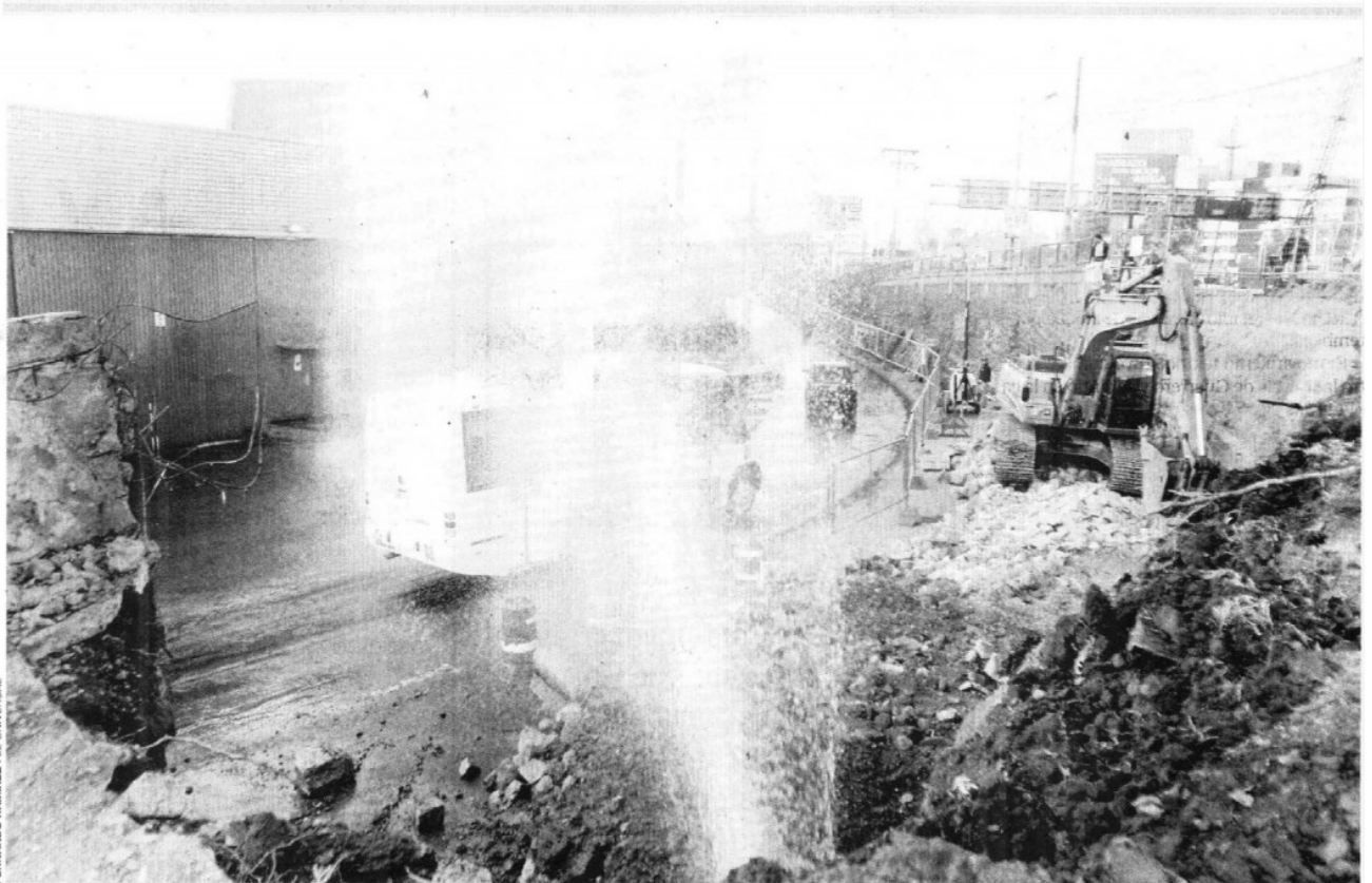
SURTIDOR Un chorro de 15 metros salió de la fisura en la tubería de agua potable. La falta de cuidado de la constructora OHL ha dejado sin agua a varias colonias
