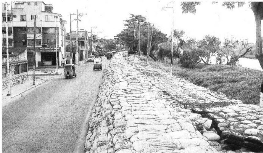
BUROCRATISMO La costalería instalada como muralla de protección provisional para contener la creciente del río Grijalva no ha sido sustituida por un muro de concreto
