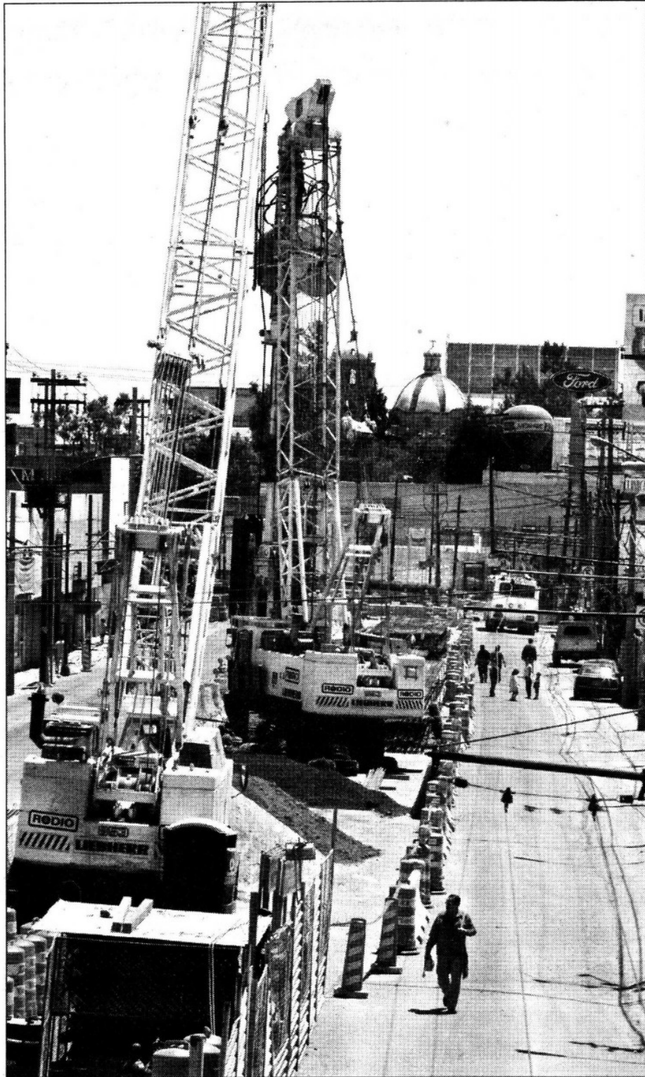
Diputados locales señalaron que existe inconformidad debido a que la construcción de la Línea Dorada "lesiona los intereses de personas que viven de la agricultura". En la imagen, la calzada Ermita Iztapalapa, cerrada en un tramo por las obras ■ Foto Víctor Camacho
