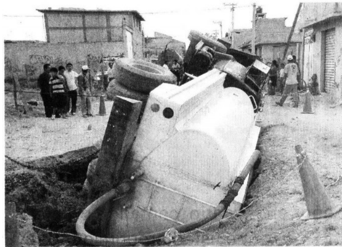
BOQUETE El fin de semana pasado, una pipa particular cayó en la zanja de siete metros dejada por trabajadores
