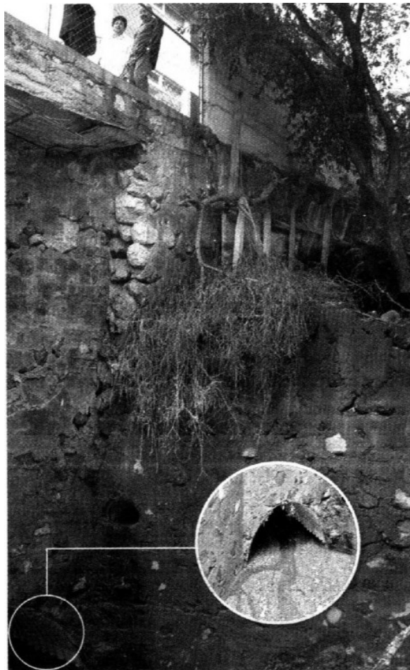
> El residencial está a 11 metros arriba del cauce del río y el ducto para desalojar las aguas está azolvado casi en su totalidad.
