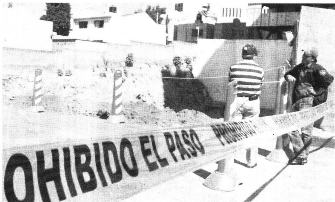
COLAPSO En Álamo Plateado se cimentaba un edificio propiedad de Raúl Durán, padre del edil de Naucalpan
